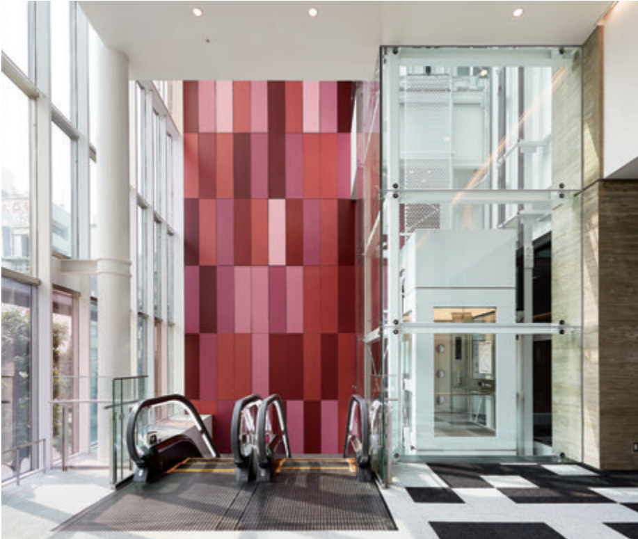
展望用18人乗りエレベーターとエスカレーター(2階)
