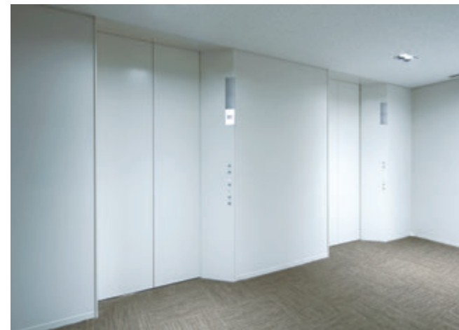
乗用15人乗りエレベーター・6階エレベーターホール（北海道テレビ放送本社）
