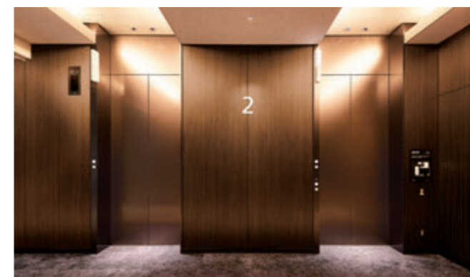
乗用19人乗りエレベーター・2階ホール
