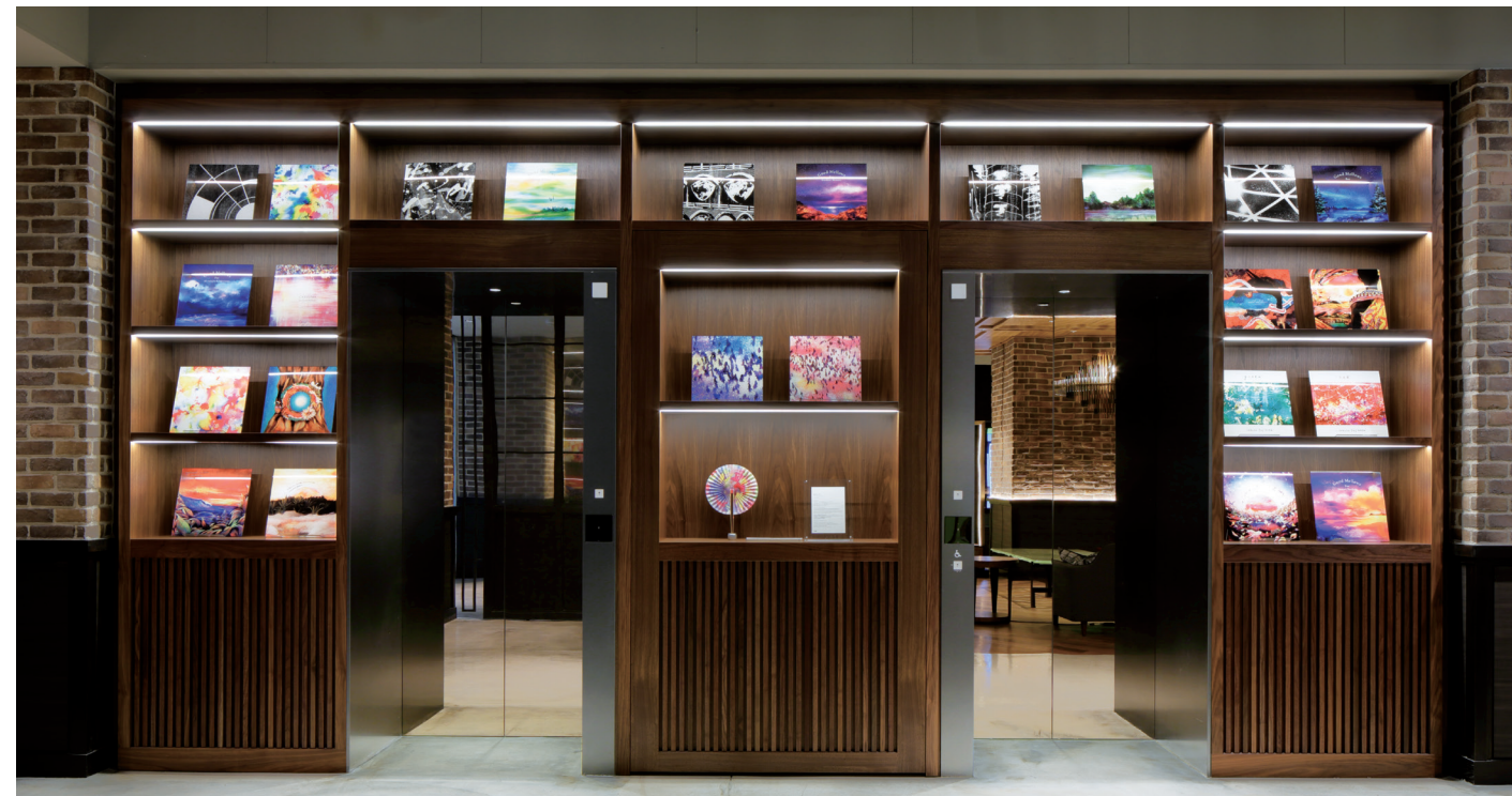
乗用15人乗りエレベーター・4階エレベーターホール
