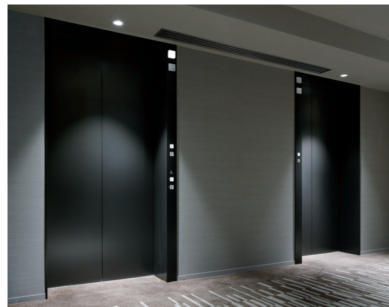
乗用15人乗りエレベーター・9階エレベーターホール
