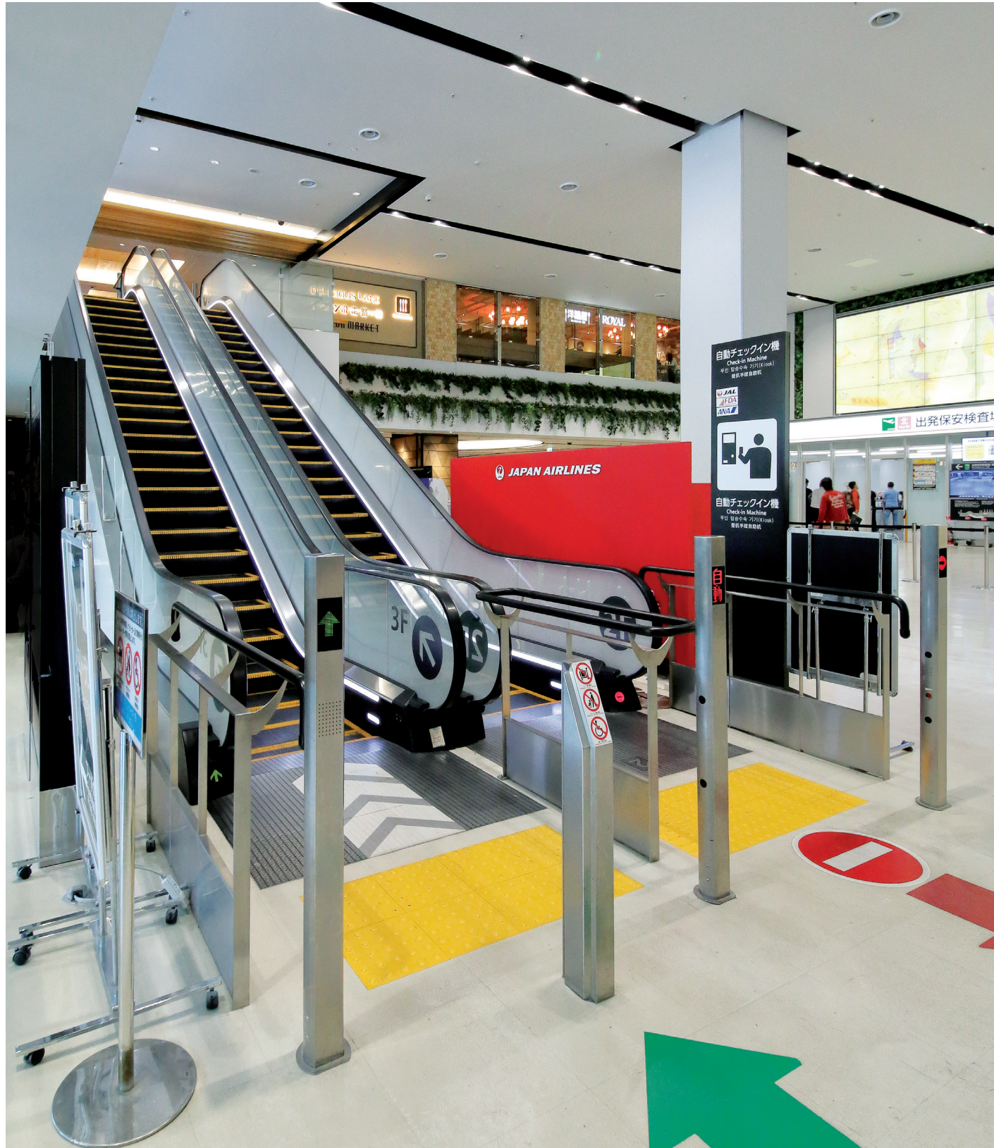
エスカレーター・2階のりば(出発ロビー／北)
