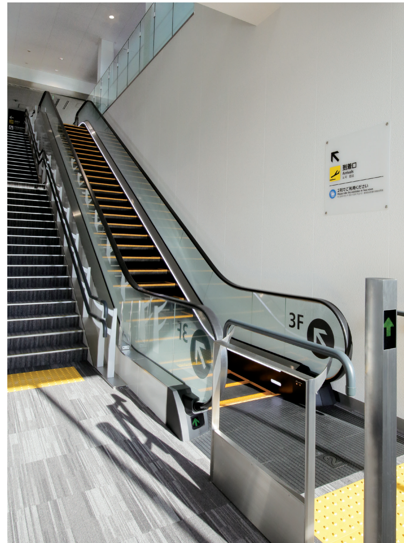
エスカレーター・到着コンコース(到着口／南)
