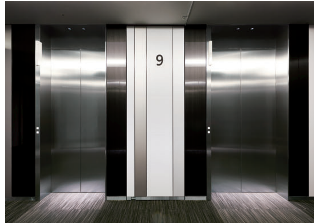
乗用20人乗りエレベーター・9階ホール
