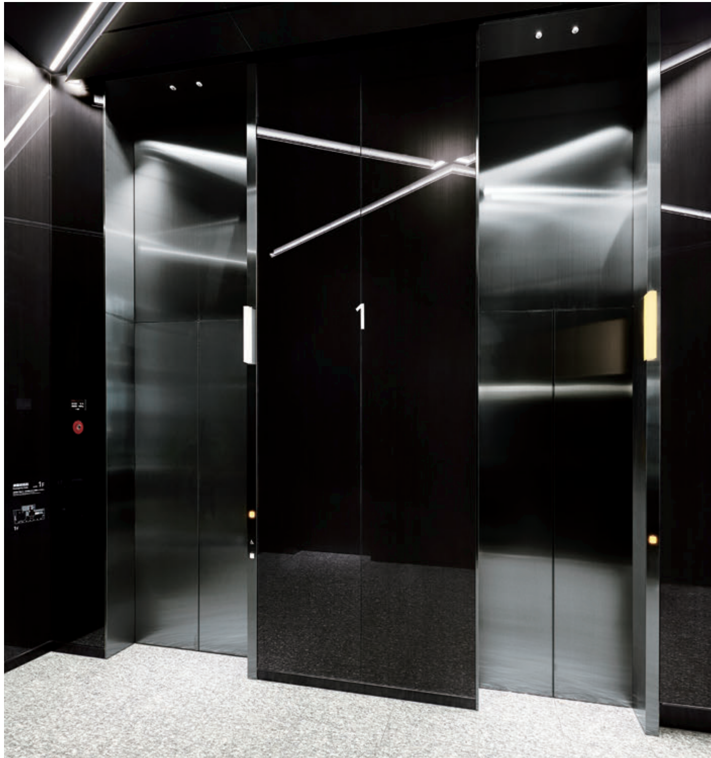
乗用(非常用)21人乗りマシンルームレスエレベーター／乗用20人乗りエレベーター・1階ホール
