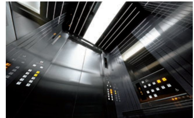
乗用(非常用)21人乗りマシンルームレスエレベーター・かご室天井
