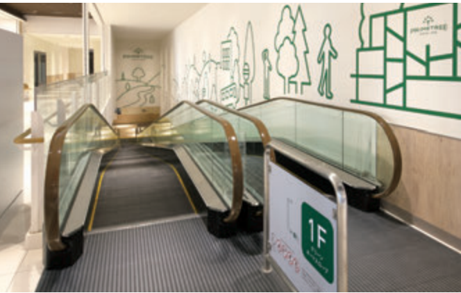
傾斜付き動く歩道・1階のりば
