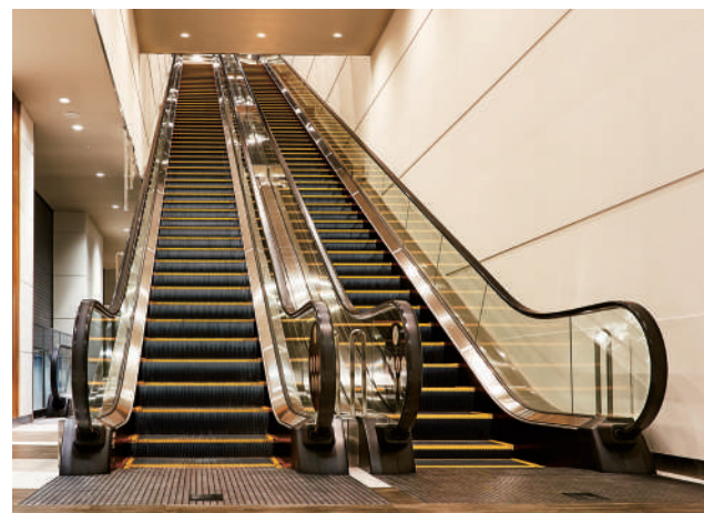
エスカレーター・1階
