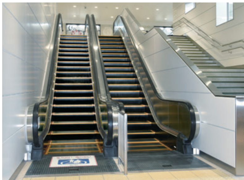
エスカレーター (千葉都市モノレール千葉駅連絡通路)
