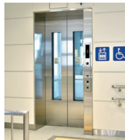
乗用15人乗りエレベーター (千葉都市モノレール千葉駅連絡通路)
