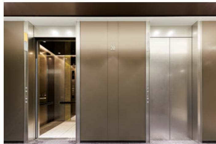
乗用24人乗りエレベーター・20階ホール
