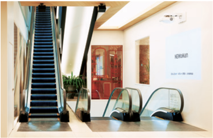
2階エスカレーター
