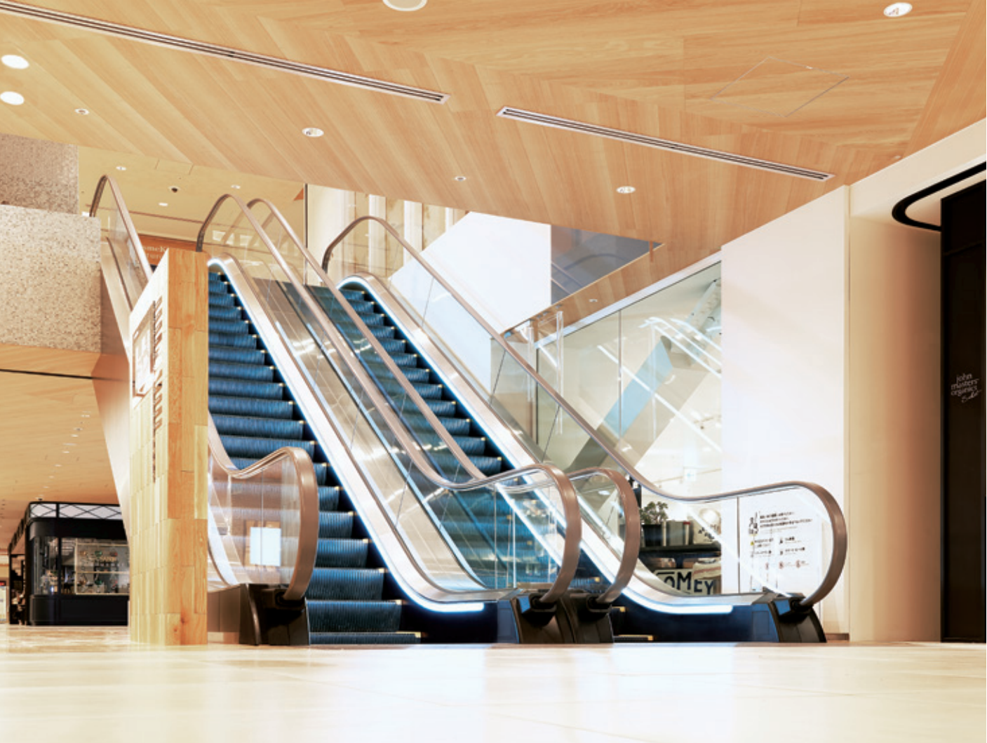
1階エスカレーター
