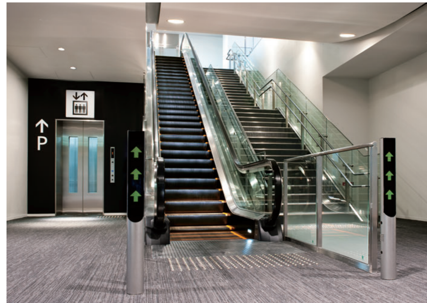
乗用15人乗りエレベーターとエスカレーター・1階
