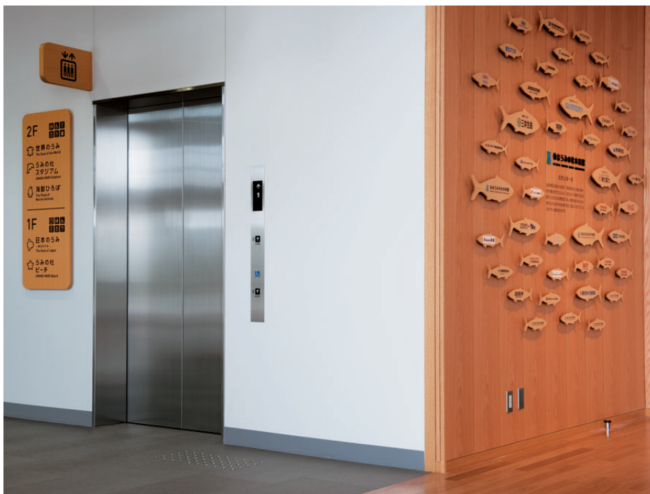
乗用20人乗りエレベーター・1階のりば(エントランスホール左)
