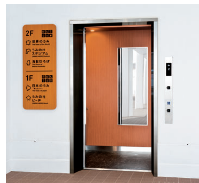
乗用20人乗りエレベーター・2階のりば(うみの杜スタジアム)
