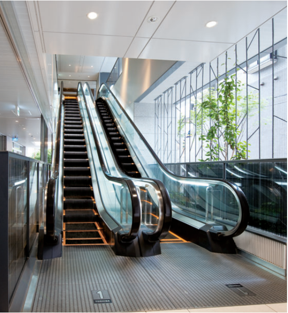
エスカレーター・1階のりば(店舗)
