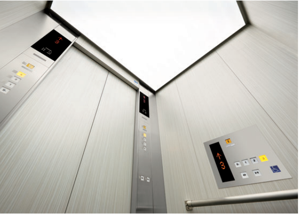
乗用13人乗りエレベーター・かご室天井(店舗)
