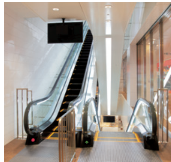
4階・東1エスカレーター
