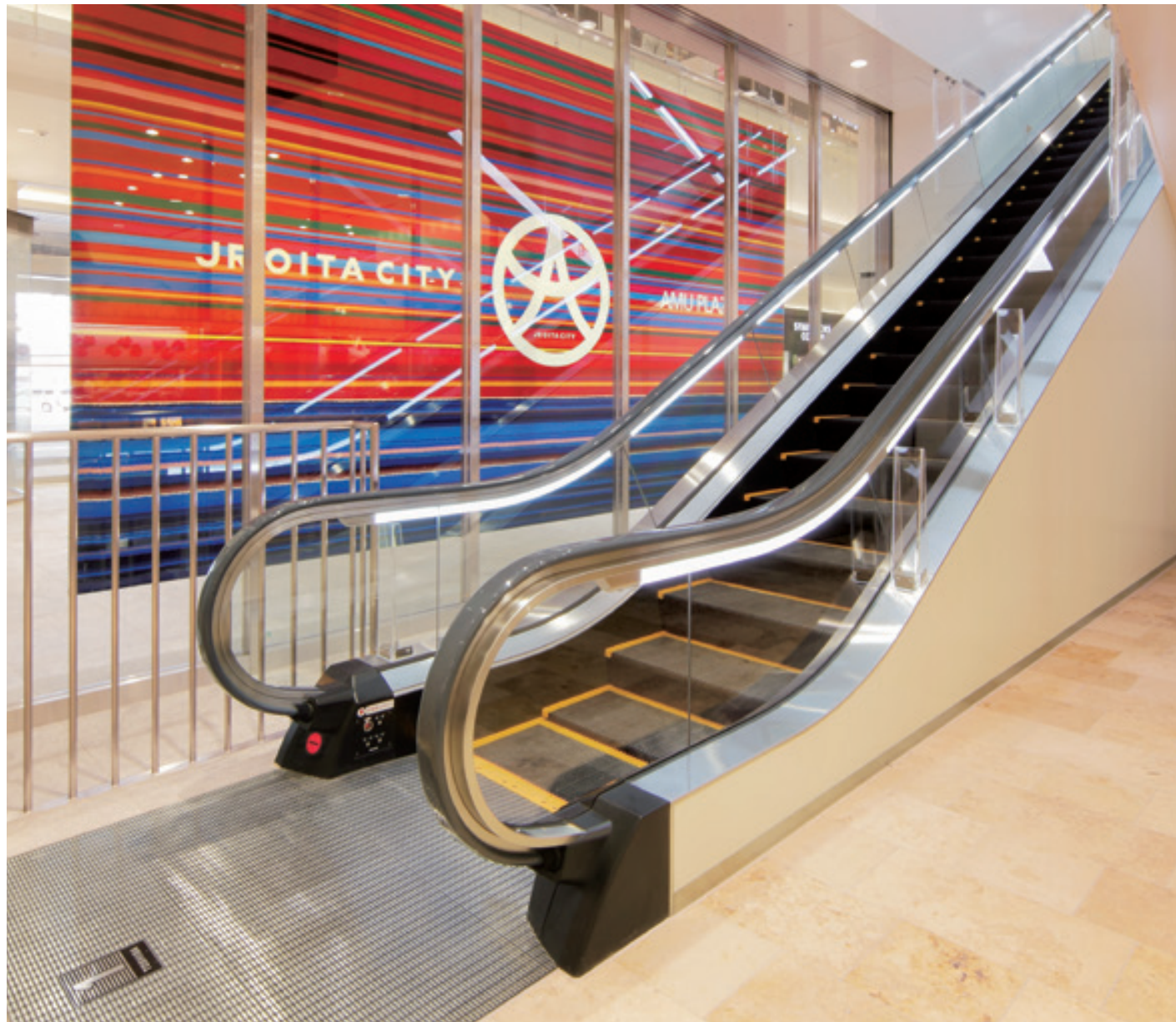
1階・中エスカレーター
