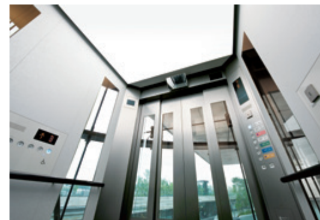
展望用エレベーター・かご室天井
