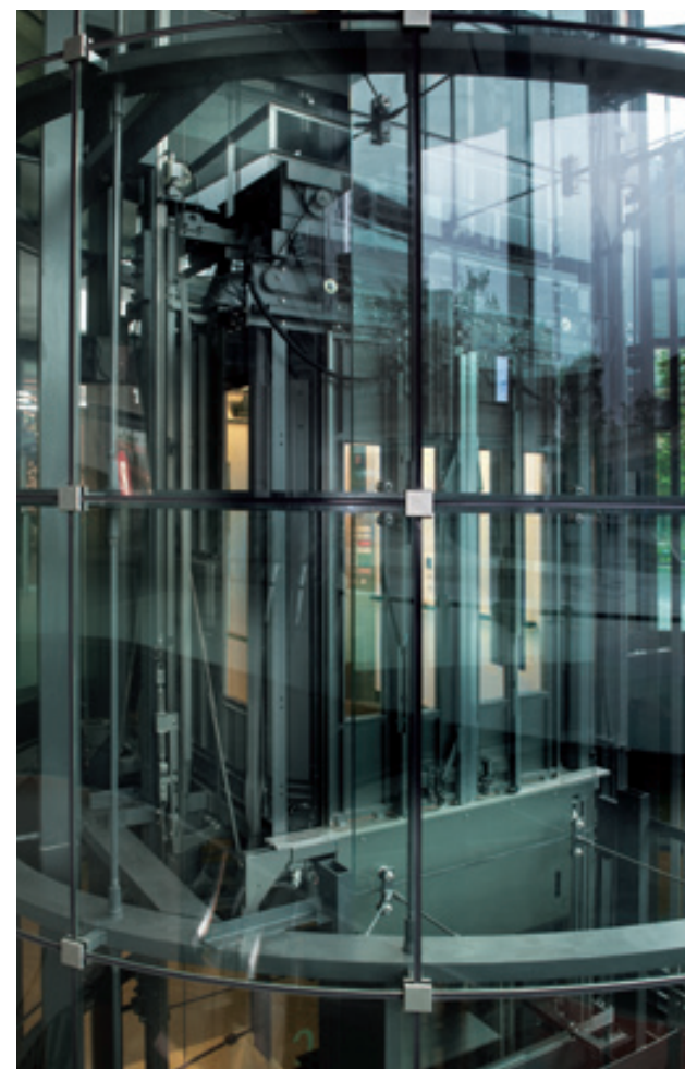
展望用エレベーター・かご室
