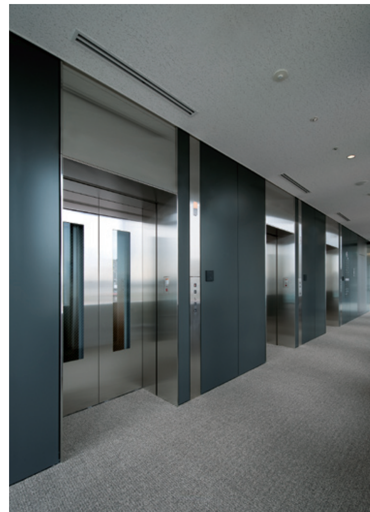
乗用17人乗りエレベーター・6階ホール
