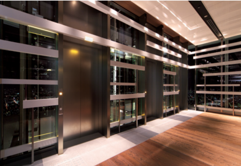
乗用20人乗りエレベーター・57階ホール
