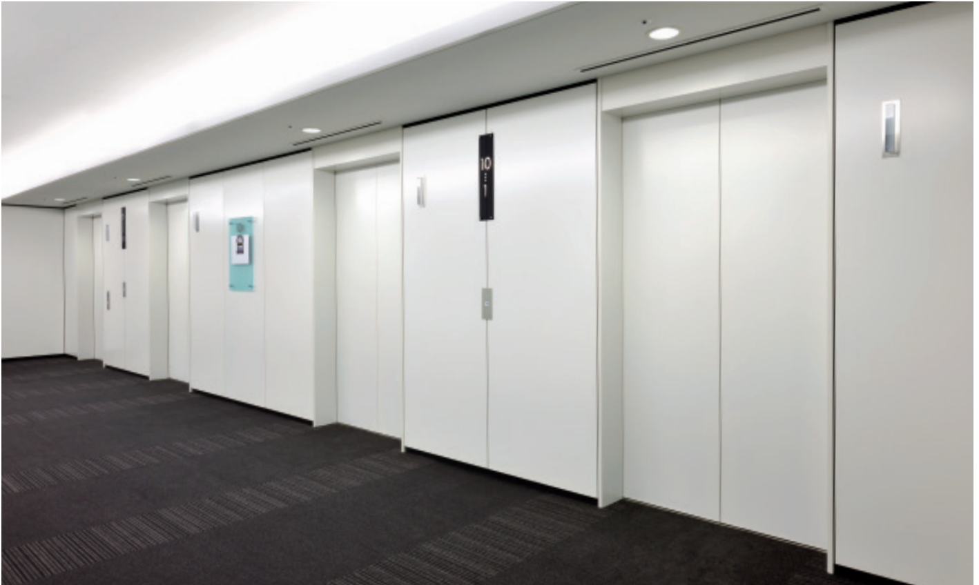
乗用エレベーター・10 階ホール
