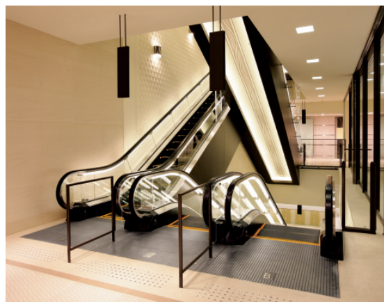
エスカレーター・地下1階
