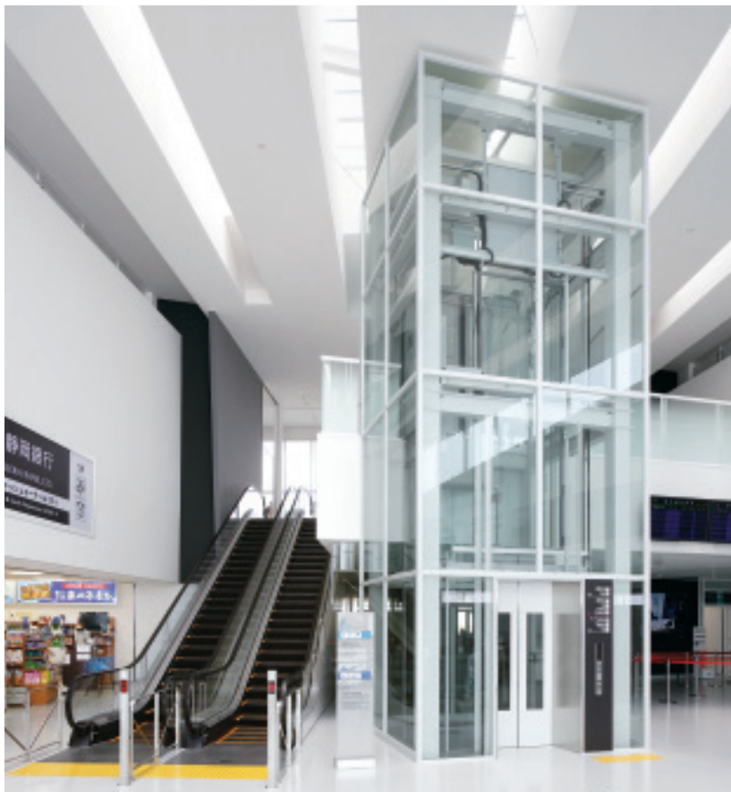
乗用(展望用)15人乗り展望用エレベーターとエスカレーター・2階
