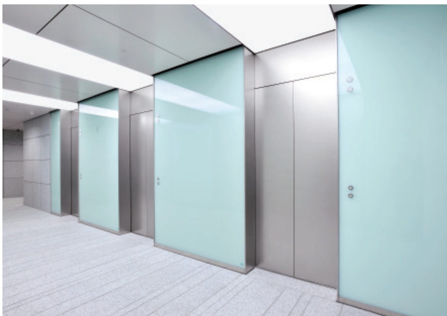
乗用エレベーター・1階ホール
