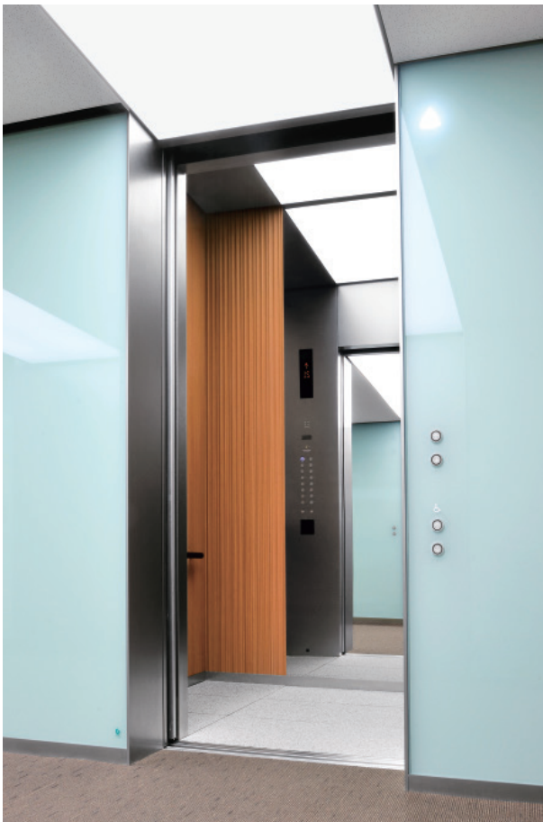
乗用エレベーター・かご室
