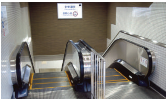
エスカレーター・駅入口
