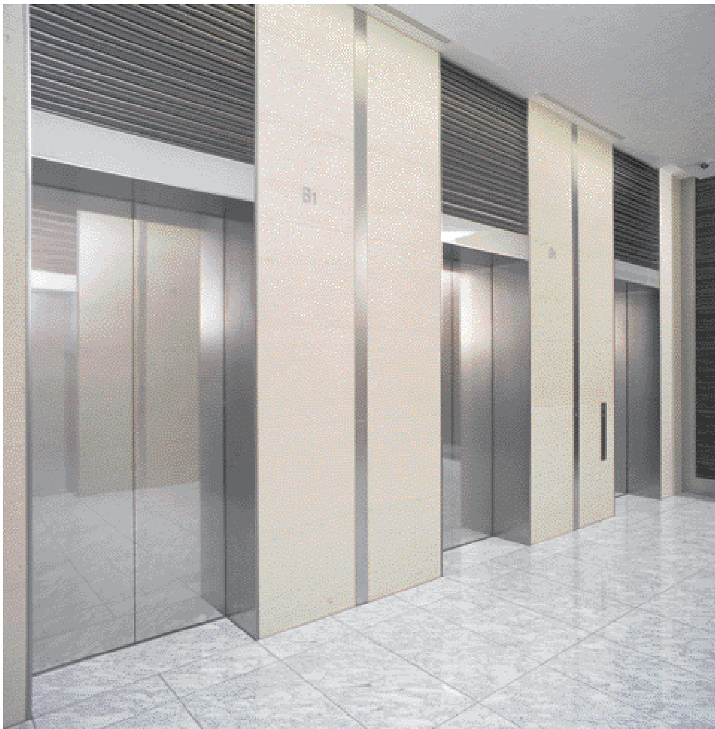
乗用24人乗りエレベーター・地下1階ホール（ミッドタウンイースト・オフィス）
