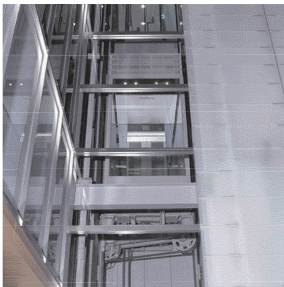
展望用エレベーター・昇降路外観 (ミッドタウン・イースト)
