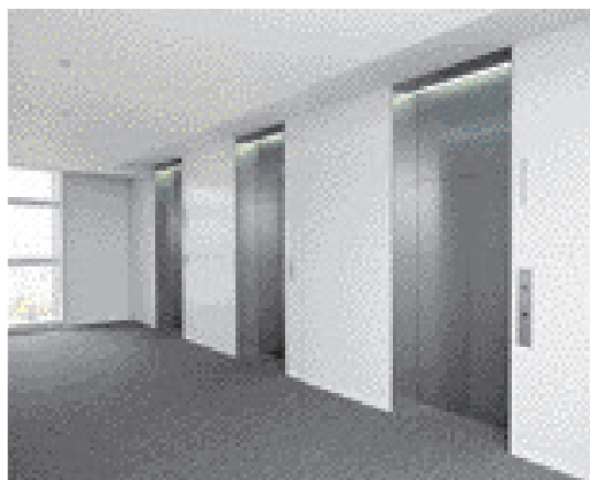
乗用エレベーター・18階ホール
