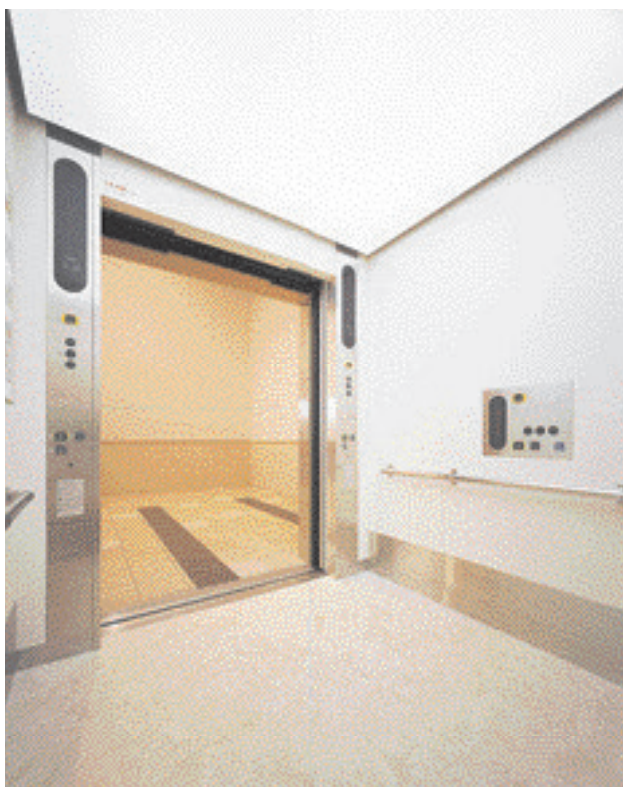
乗用エレベーター・かご室
