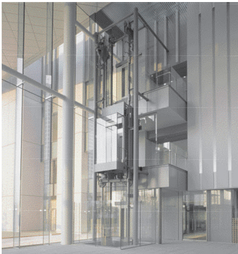
展望用17人乗りエレベーター・昇降路外観
