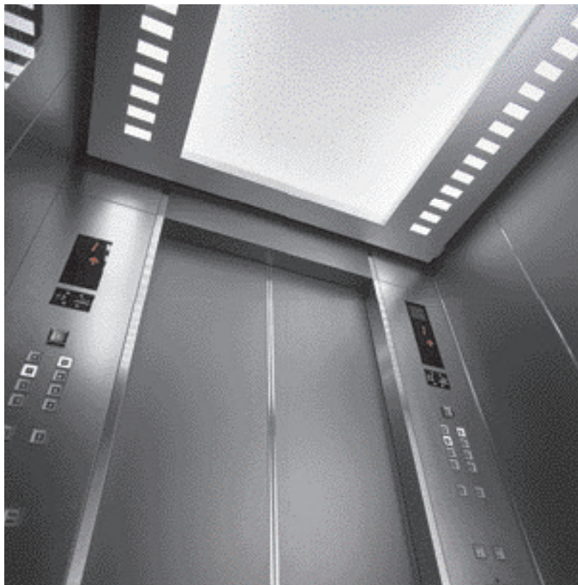
乗用エレベーター（業務棟）・かご室天井
