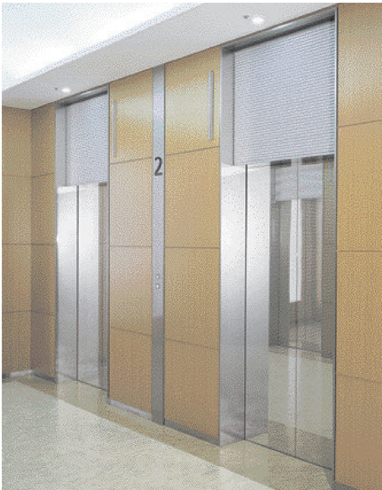
乗用エレベーター（業務棟）・1階ホール
