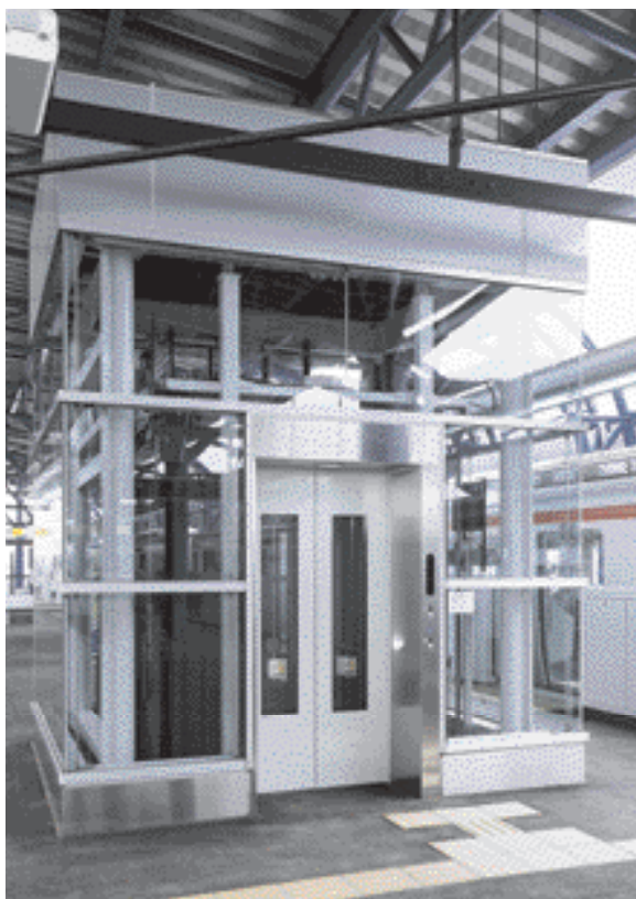
展望用エレベーター・ホーム階（流山おおたかの森駅）
