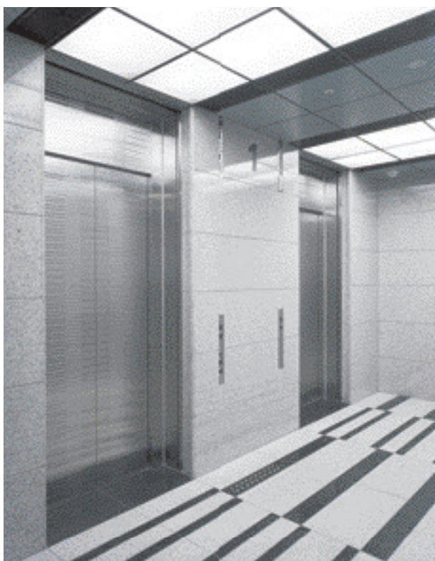
乗用20人乗り・人荷用24人乗りエレベーター・1階ホール（タワー棟）
