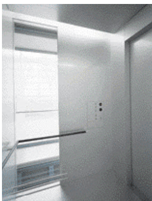
展望用エレベーター・かご室
