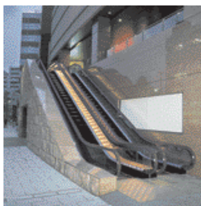
屋外エスカレーター
